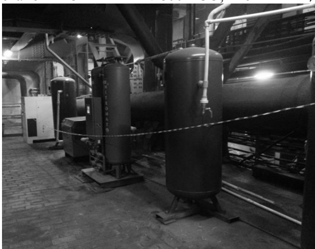
Рис. 1. Фото азотной станции ОХУМАТ N-800 ЕСО, смонтированной в цехе ТСС ОФ №3 МГОКа
